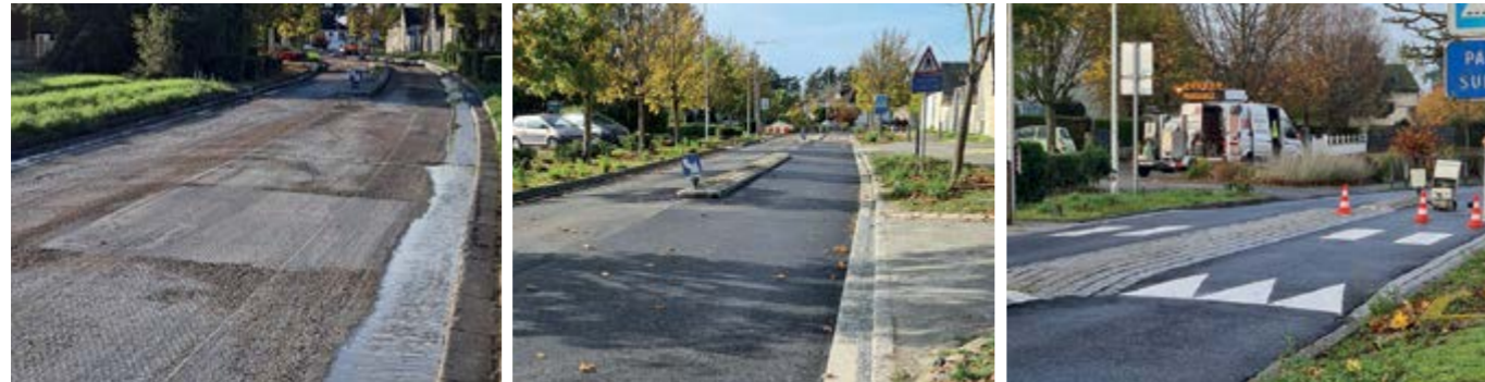
Travaux route d'Orléans, après l'arasement de la route, remise en bitume et reprise du marquage.
